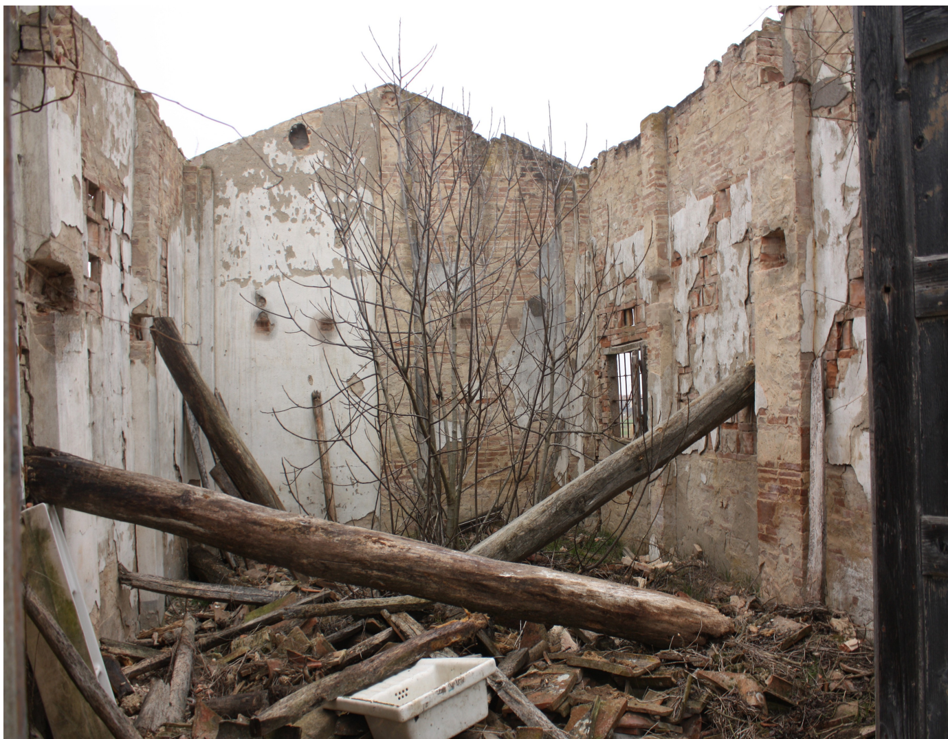
Foto n.8: Foto interne del fienile prima del crollo
