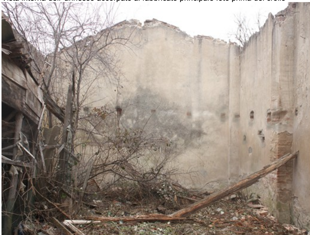
Foto n°6: Vista interna dell' annesso accorpato al fabbricato principale foto prima del crollo
