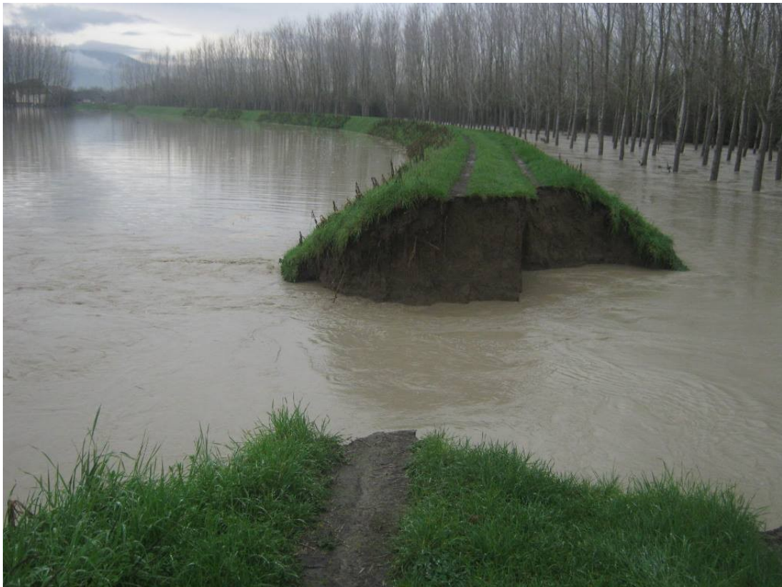
1. Figura 3.32: Breccia dell'argine sinistro del Fiume Era presso la zona sud-est di Ponsacco durante l'evento del 30 Gennaio/1 Febbraio 2014.
